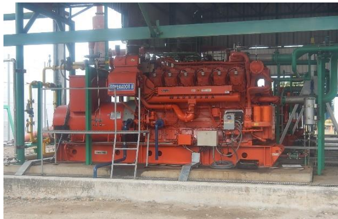
Figura 4 - 32. Zona de Generación
